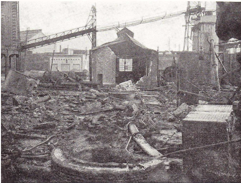
Société Cockerill, Seraing. — Four à coke, installation de la récupération, après le départ des Allemands.
